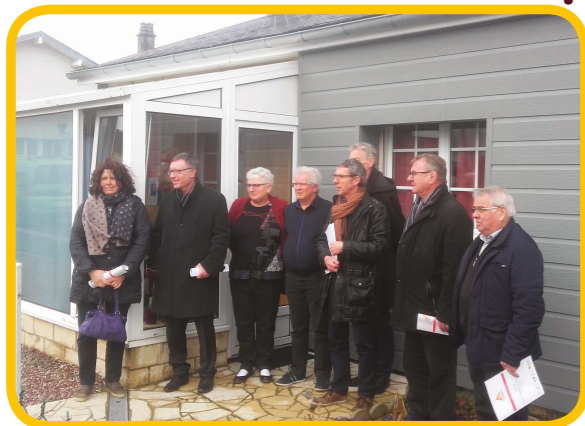
MARS Visites de chantiers de logements renovés dans le cadre de l'opération programmée d'amélioration de l'habitat (OPAH)
